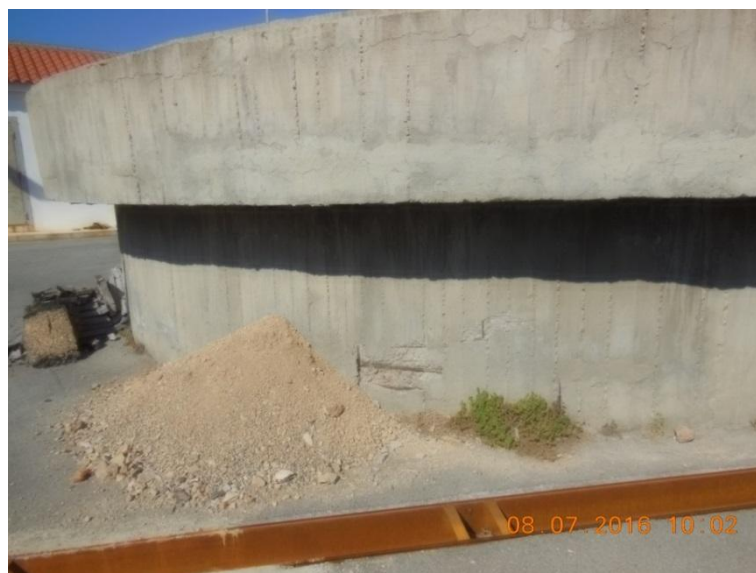
Εικόνα 14 Αποκάλυψη σπλισμού στην παλιά ΔΤΚ
