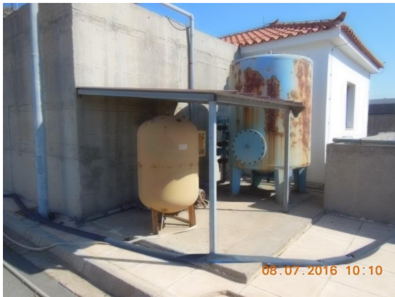
Εικόνα 17 Χώρος εγκατάστασης φίλτρου και αντλιών βιομηχανικού νερού
