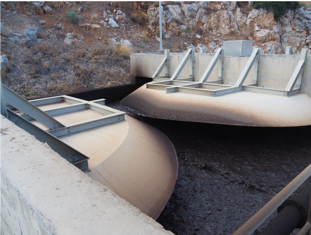
Εικόνα 10 Σκέπαστρα αεριστήρων νέας δεξαμενής αερισμού
