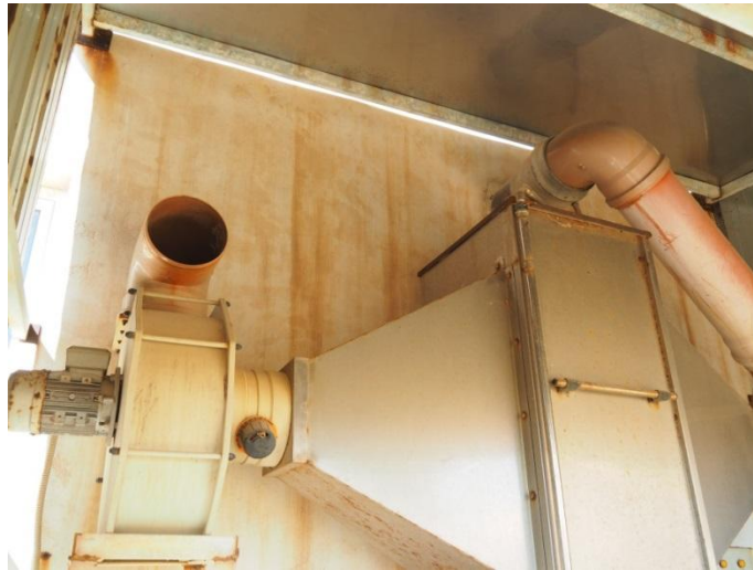
Εικόνα 5 Υφιστάμενο σύστημα απόσμησης
