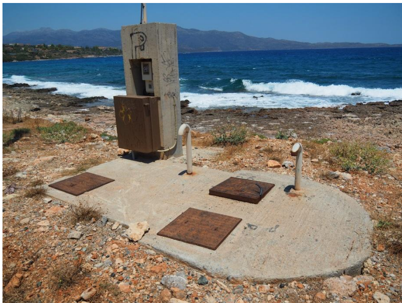
Εικόνα 20 Αντλιοστάσιο Γλυφάδας (Α/Σ-2)
