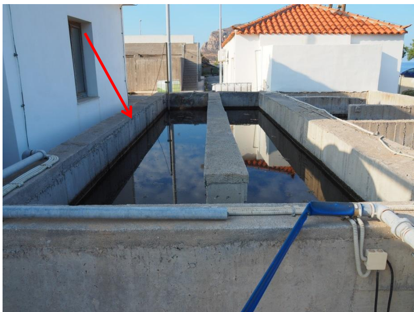
Εικόνα 15 Θέση εγκατάστασης συστήματος UV στη δεξαμενή χλωρίωσης
