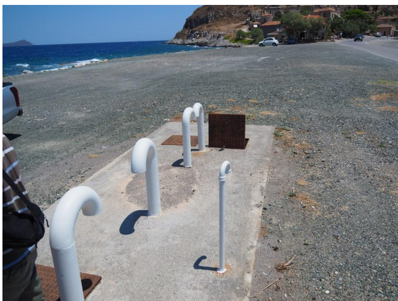
Εικόνα 18 Αντλιοστάσιο Γέφυρας (Α/Σ-Β)
